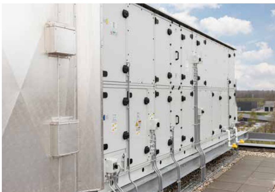
Van luchtbehandelingskast tot verdeeltechniek en meet- en regelsystemen en van advies en ontwerp tot inbedrijfstelling: Solid Air Climate Solutions is scholen graag van dienst.
